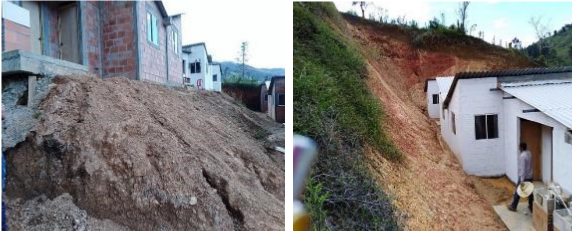
Figura 13. Talud con roca expuesta, cercano a las viviendas y problema de estabilidad en el cimiento de algunas viviendas
