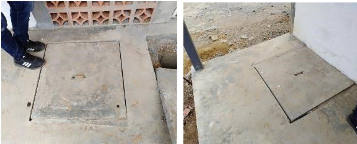
Figura 11. STARD ubicados en el frente de cada vivienda – Anden
