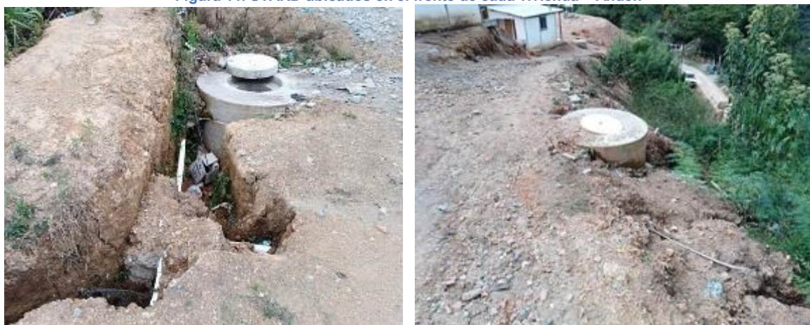
Figura 12. Alcantarillas sobre terreno agrietado y con problemas de estabilidad
