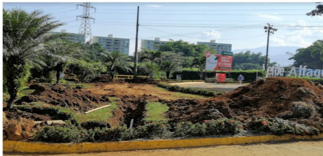
Imágenes 6, 7 y 8: Remoción de terreno e instalación de tubería sobre la FFP del zanjón del Medio en el sector de Alfaguara. El tubo se ha pasado bajo el cauce del zanjón.
