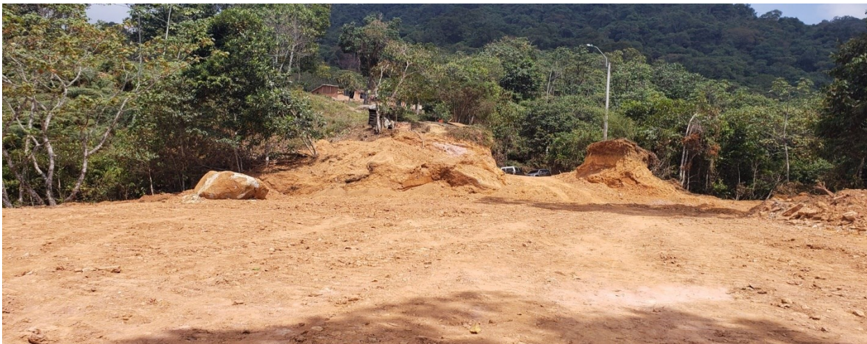
Foto 14. Dimensionamiento de la explanación realizada, foto tomada desde el interior del predio.
