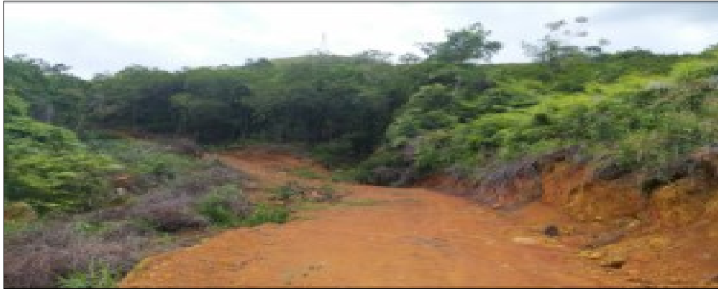
Imagen 3. Carretera que interseca la margen derecha de la carretera (Potrerito – Rio Claro) hasta lugar que presenta una Explanación – Sin presencia de sistema de drenaje (cunetas, filtros, etc)
