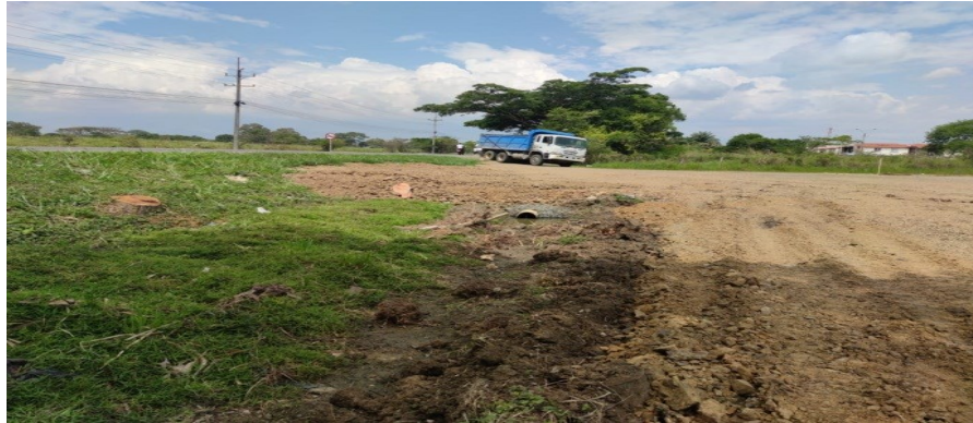
Imágenes 5, 46, 47, 48, 49, 50 y 51. Continuación de obras comprometiendo los recursos naturales objeto de regulación.
