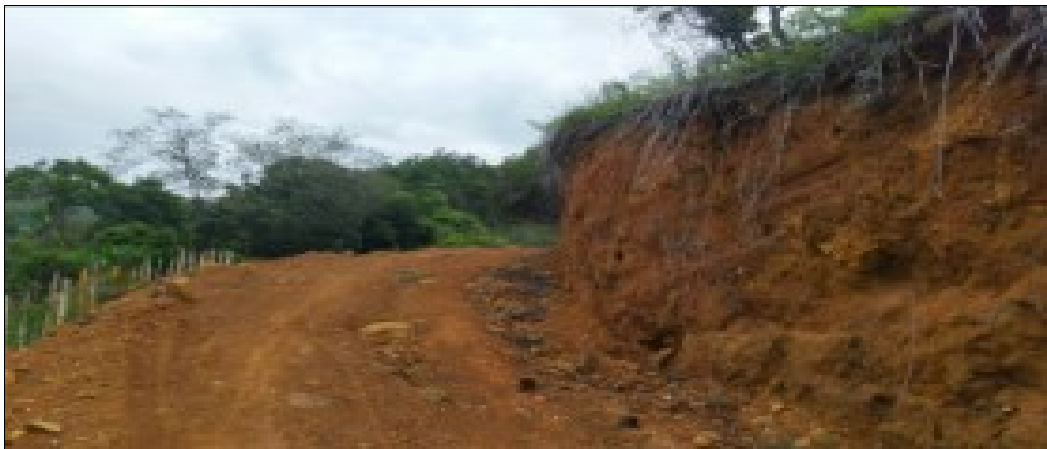
Imagen 4. Carretera que interseca la margen derecha de la carretera (Potrerito – Rio Claro) hasta lugar que presenta una Explanación – detalle de taludes de corte sin ningún tratamiento.
