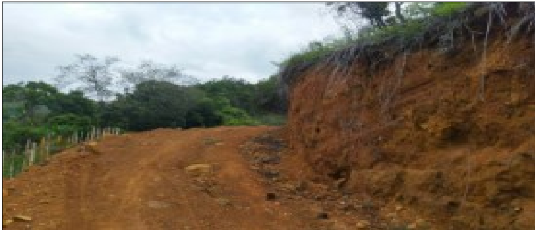
Imagen 4. Carretera que interseca la margen derecha de la carretera (Potrerito – Rio Claro) hasta lugar que presenta una Explanación – detalle de taludes de corte sin ningún tratamiento.
