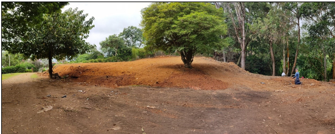
Figura 2. Vista general desde la parte inferior y de acceso a la adecuación del terreno.
