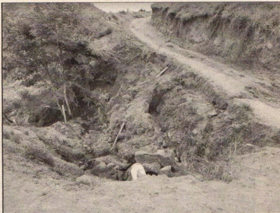
Fotografía N° 6: Tubería de salida de agua
