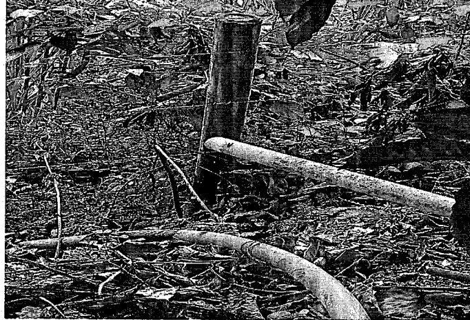
Fotografía 3. Tubería desagües aguas lavadero – lavaplatos y duchas
