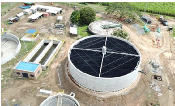
Foto 26. PTAR municipio de Yumbo, Archivo CVC-2022.
