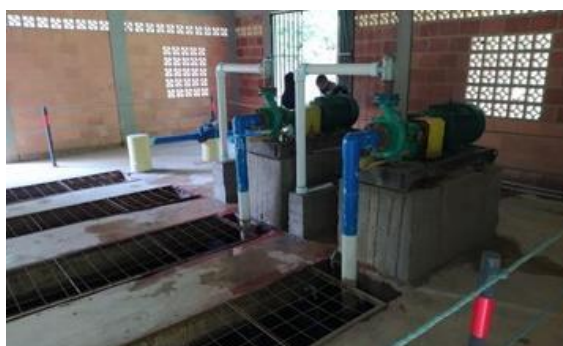
Foto 43. Estación de bombeo Zúñiga, municipio de Caicedonia, Archivo CVC 2022.
