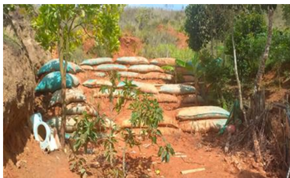
Foto 15. Municipio de Bolívar corregimiento la Primavera, Construcción de bolsas de suelo cemento para estabilización de áreas en proceso de erosión, Archivo CVC-2022.
