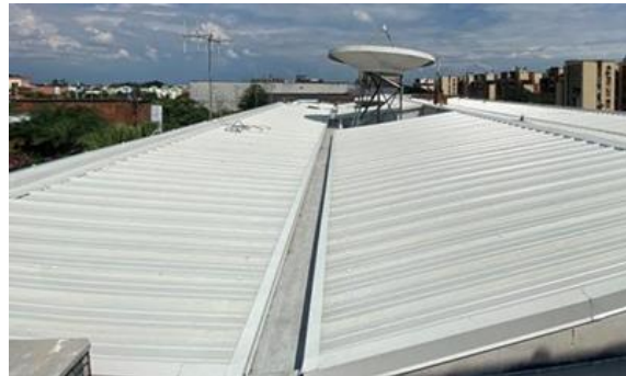
Foto 132. Cambio de la cubierta en teja fibrocemento por teja tipo sándwich del edificio principal, Archivo CVC, 2022
