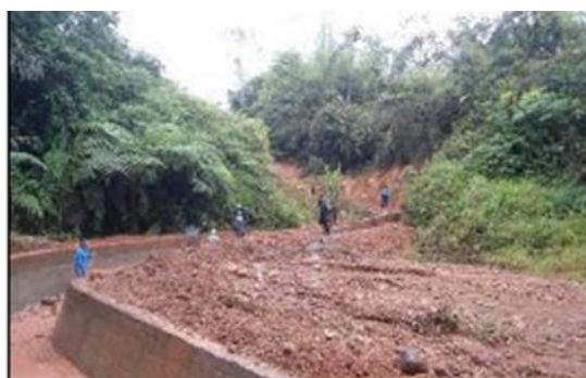
Foto 107. Afloramiento de la superficie de falla del movimiento en masa en la margen izquierda de la quebrada San José y canalización de la quebrada San José, Archivo CVC, 2022
