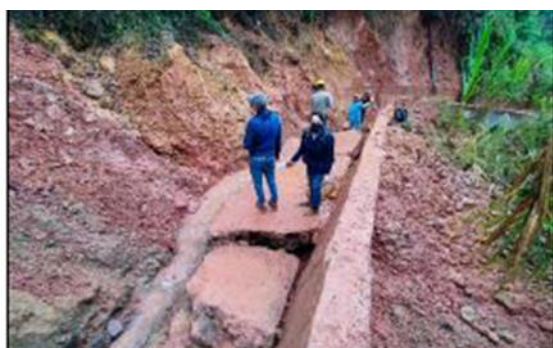
Foto 106. Afloramiento de la superficie de falla del movimiento en masa en la margen izquierda de la quebrada San José y canalización de la quebrada San José, Archivo CVC, 2022
