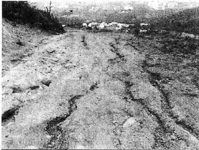
FOTO 2: ESTADO DE LA VIA, SIN ESTRUCTURAS DE DRENAJE Y EROSIONADA
