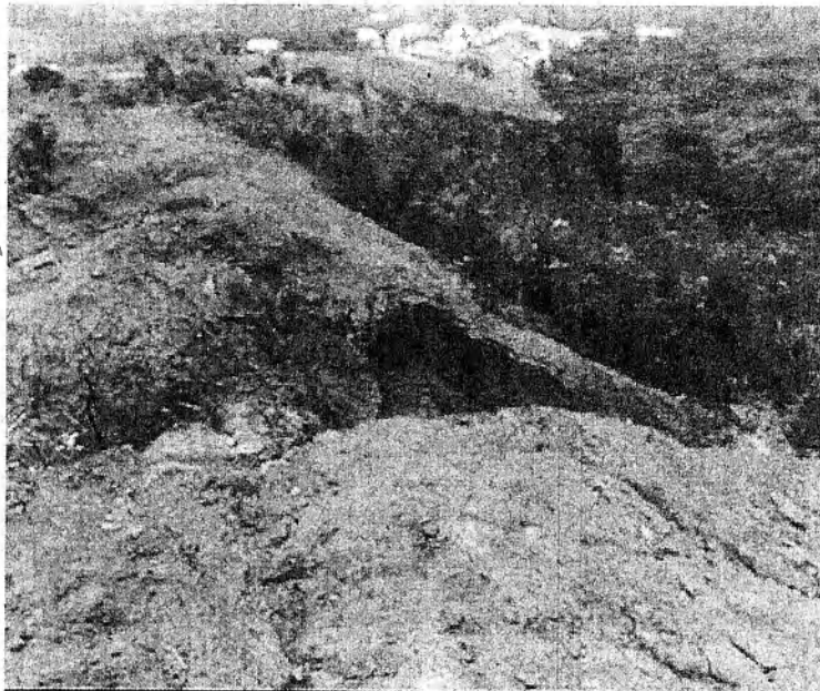
FOTO 3: LOS SOBRANTES DE EXCAVACION, LA ESCORRENTIA ARRASTRA LA TIERRA HACIA LA QUEBRADA MENGA, UBICADA AL FONDO DEL TALUD DERECHO
