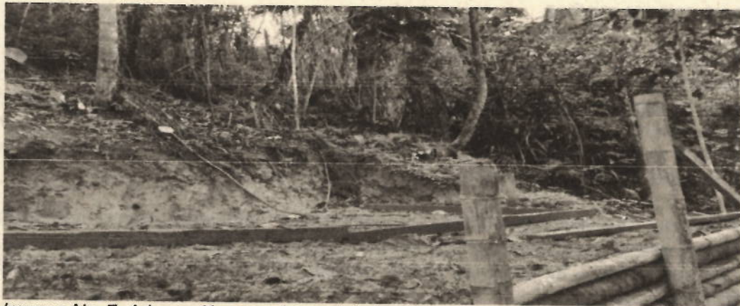
Imagen No. 7. Adecuación espacio, en deterioro
