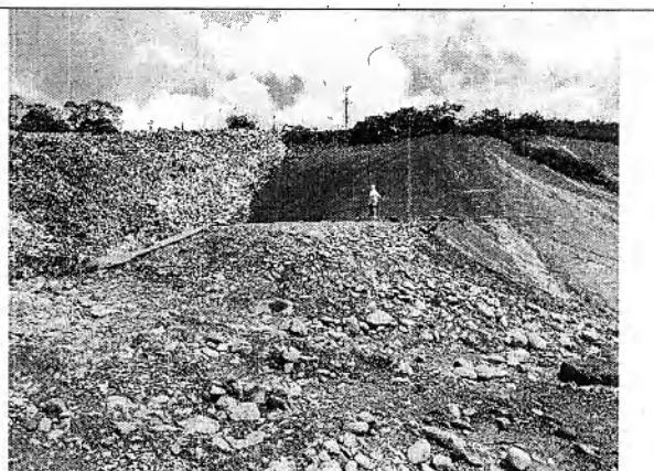
Fotografía 2: Vaso optimizado 1, costado derecho visto desde enfrente (lado A); aún posee un área para disposición de residuos sólidos que se estima puede recibir residuos hasta el mes de diciembre de 2023.
