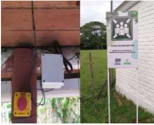
Foto 128. Instalación de alerta temprana y punto de encuentro en el municipio de Bolívar – Corregimiento San Antonio de Gaure, Archivo CVC.
