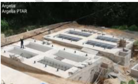
Foto 35. Avance en la construcción de la PTAR de la cabecera municipal de Argelia. Archivo CVC.
