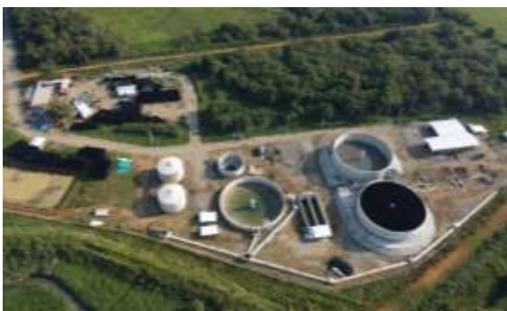
Foto 33. Avance en la construcción de la PTAR de la cabecera municipal de Jamundí. Archivo CVC.
