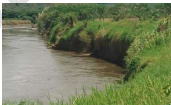
Foto 136. Pérdida parcial del dique en el predio El Paraíso, corregimiento El Salto. Municipio de Andalucía. Archivo CVC, 2023
