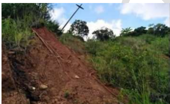
Foto 135. Deslizamiento en la vía que comunica la cabecera municipal de Sevilla con el centro poblado de Samaria, vereda El Crucero, riesgo de afectación al acueducto del municipio de Caicedonia. Municipio de Sevilla. Archivo CVC, 2023
