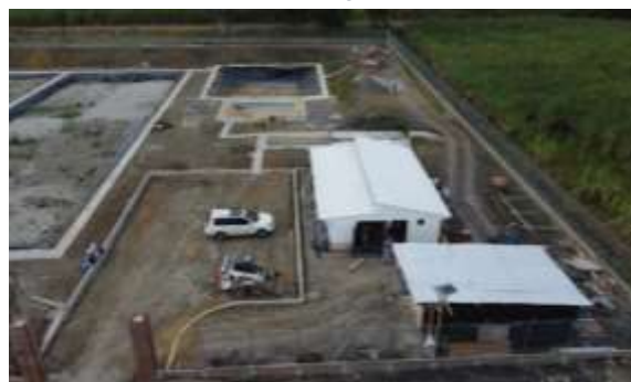
Foto 36. Avance en la construcción de la PTAR del corregimiento Zanjón Hondo. Archivo CVC.
