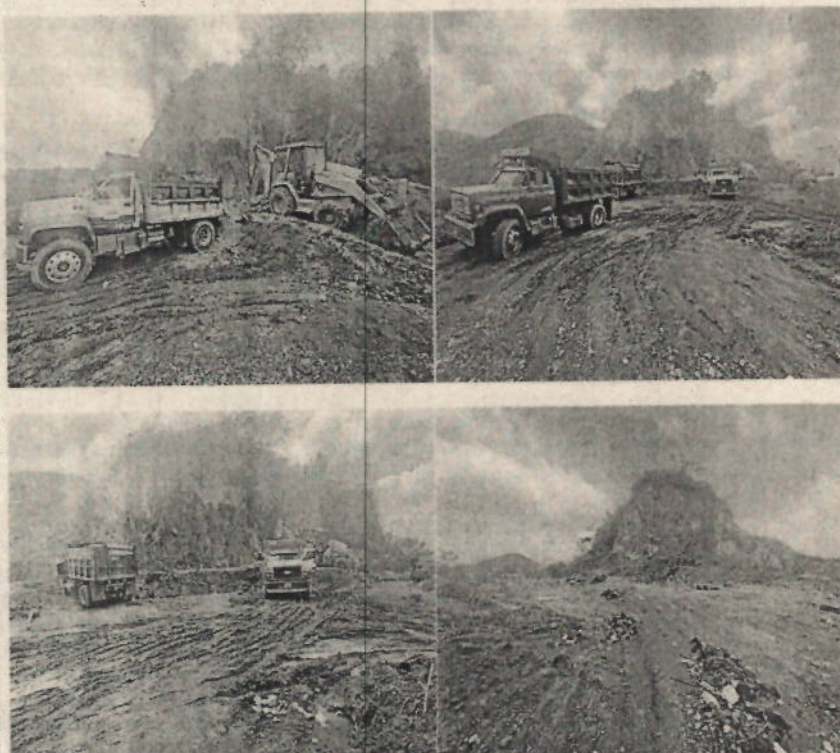
Fotografías correspondientes a la explotación ilegal mecanizada a cielo abierto.
