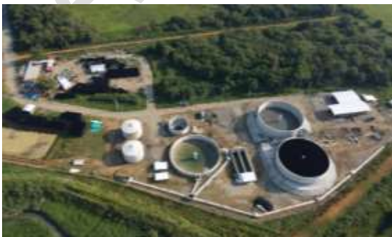
Foto 34. Avance en la construcción de la PTAR de la cabecera municipal de Jamundí. Archivo CVC. 2023
