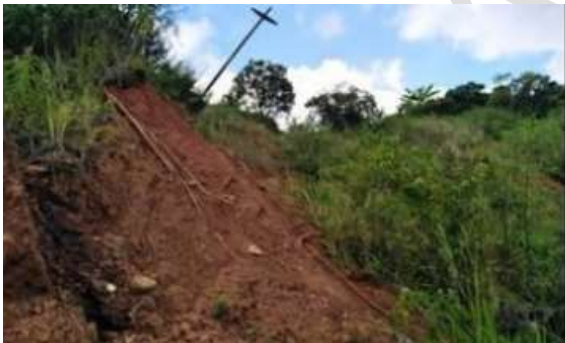
Foto 153. Deslizamiento en la vía que comunica la cabecera municipal de Sevilla con el centro poblado de Samaria, vereda El Crucero, riesgo de afectación al acueducto del municipio de Caicedonia. Municipio de Sevilla. Archivo CVC, 2023
