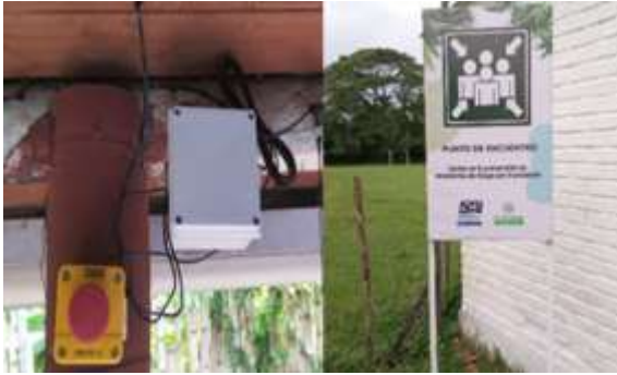
Foto 146. Instalación de alerta temprana y punto de encuentro en el municipio de Bolívar – Corregimiento San Antonio de Gaure, Archivo CVC, 2023.
