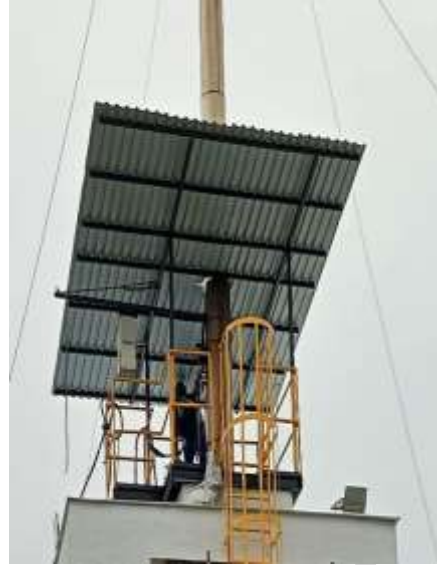
Foto 110. Monitoreo de fuentes fijas, plataforma de incineradora (Vista 2). Archivo CVC, 2023
