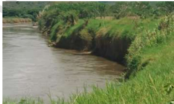
Foto 154. Pérdida parcial del dique en el predio El Paraíso, corregimiento El Salto. Municipio de Andalucía. Archivo CVC, 2023
