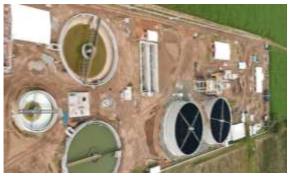
Foto 35. Avance en la construcción de la PTAR de la cabecera municipal de Buga. Archivo CVC. 2023
