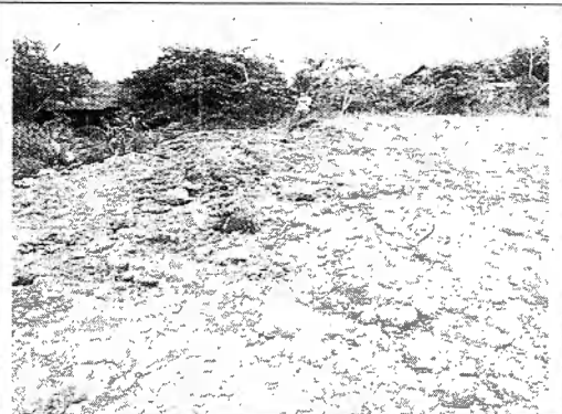
Fotografía No. 8. Se observa huellas de acarreo de sedimentos desde el lote hacia el área donde llegan las aguas y donde se encuentra instalado el tubo en concreto de 60”.
