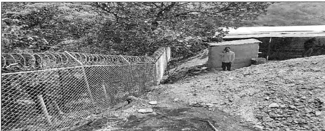
Foto 5. Vista lateral del material producto de excavación cerca del área forestal protectora de corrientes intermitentes y caseta de obra (lindero norte)
