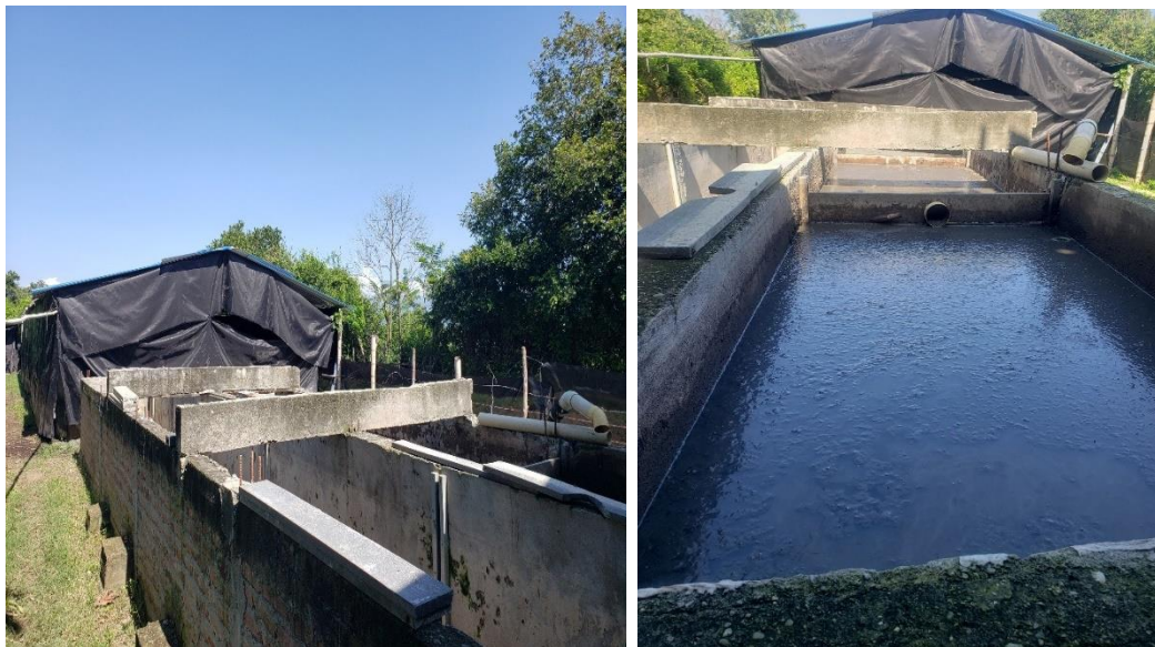
Foto. Tanques sedimentadores
