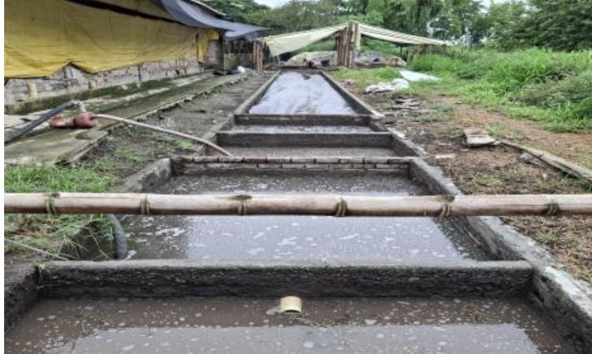
Foto. Sedimentador tipo baffles, lecho de secados, biodigestor y tanques estercoleros
