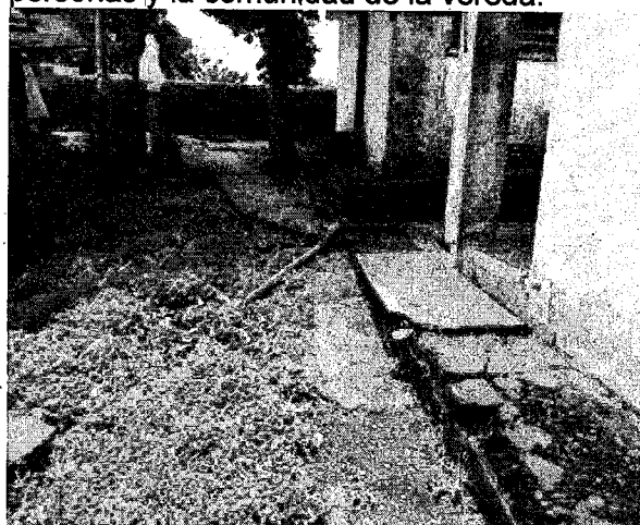
Ilustración 6. TUBERÍA EXPUESTA QUE CONDUCE LAS AGUAS NEGRAS A UN SITIO-CERCANO. DANIEL H. CVC 2025.
