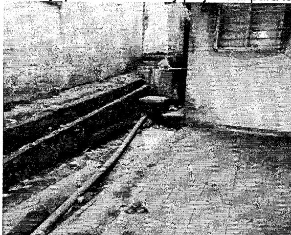
Ilustración 5. TUBERÍA EXPUESTA DE AGUAS NEGRAS QUE SALE DEL ANTIGUO PUESTO DE SALUD. DANIEL H. CVC 2025.
