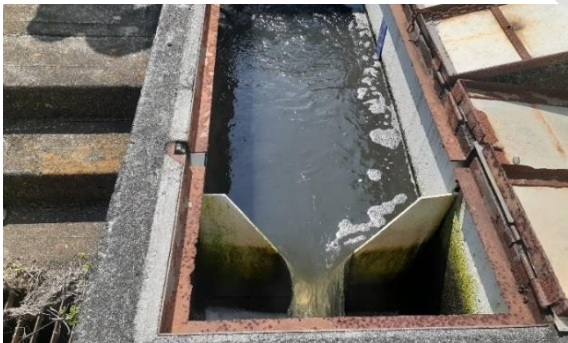
Foto 95. Estructura de Medición de Caudal, Planta de Tratamiento para Aguas Residuales para la zona urbana del municipio de Calima – El Darién. Archivo CVC, 2025
