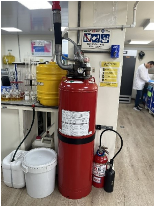
Foto 17. Tanque gas contra incendio – Área Cromatografía
