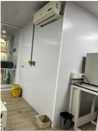
Foto 7. Aire acondicionado con goteo – área de Extracción y Destilación
