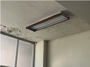
Foto 5. Humedad cielo raso y luminaria incompleta instrumentación
