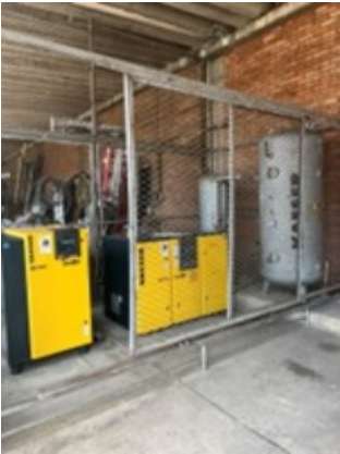
Foto 18. Área Equipos de vacío
