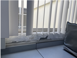
Foto 6. Desprendimiento de Pared – Área
