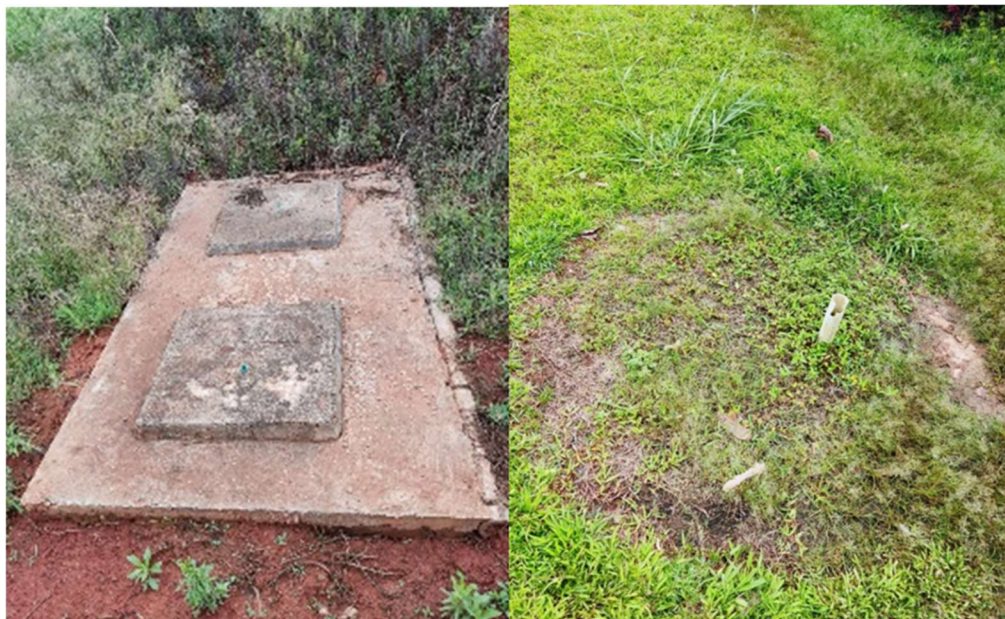
Figura 29. Pozos sépticos en predios.
