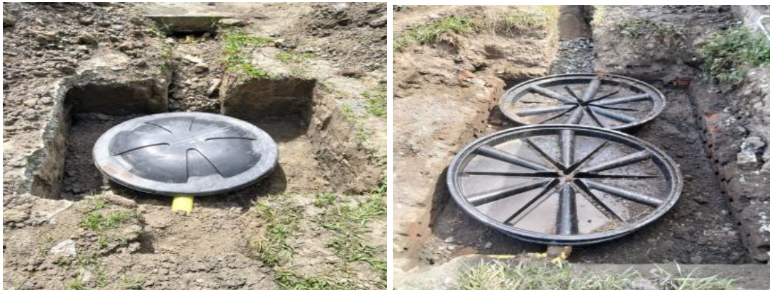
Foto. Trampa de grasas, tanque séptico y filtro anaerobio
