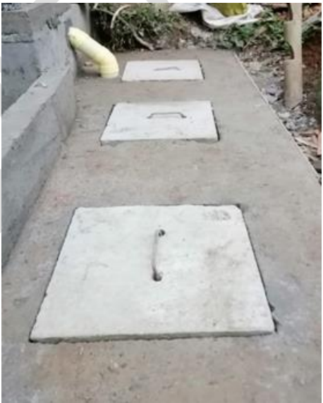
Foto 121. Tanque séptico, filtro anaerobio y batería sanitaria para la Comunidad Indígena Ankonedrua en el municipio de Sevilla. Archivo CVC, 2026
