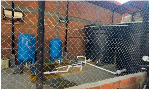
Foto 129. Seguimiento permisos de vertimiento. Sistema de tratamiento de agua para uso y aprovechamiento. DAR Norte, predio Los Almendros, Vereda La Estrella, Municipio de Alcalá. Archivo CVC, 2025
