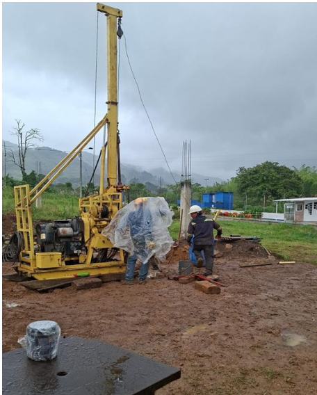
Foto 143. Exploración Directa en suelos de la zona urbana del municipio de Calima. Archivo CVC, 2025
