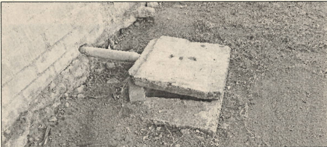
Foto 11. Vista de cajas recolectoras donde llegan las aguas de lavados de establos.
