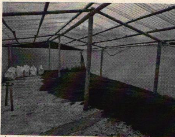
Foto 2 y 3. Panorámica de la nueva marquesina para manejo de estiércol (lechos de secado)
