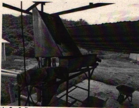
Foto 8 y 9. Panorámica separador de solidos en adecuación
