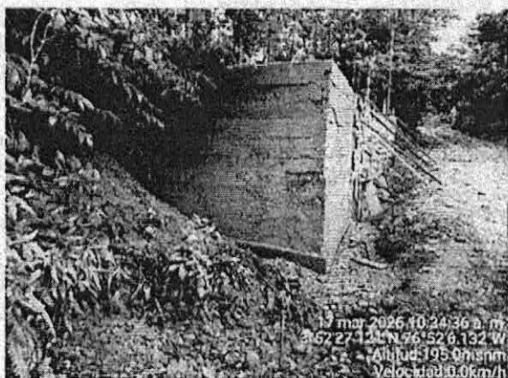
Foto 33. Costado izquierdo muro.
