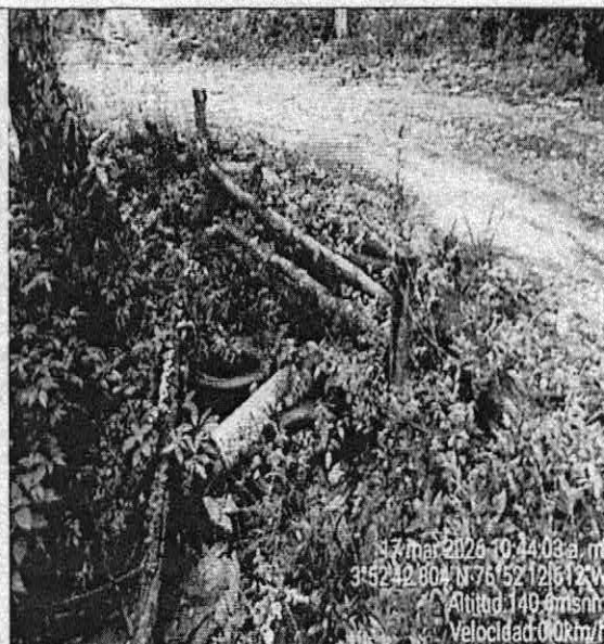
Foto 8. Descarga de agua sobre la vía.
