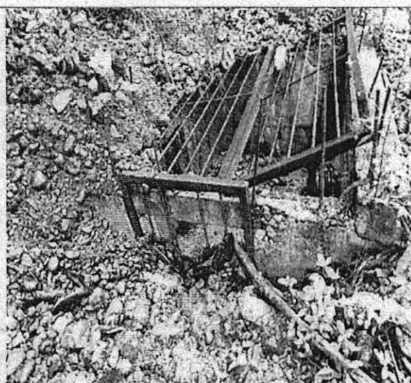
Foto 10. Obstrucción de caja por caída de tierra.
