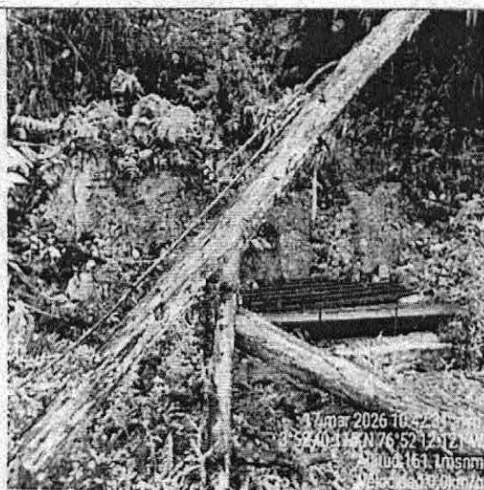
Foto 9. Caja de inspección.
