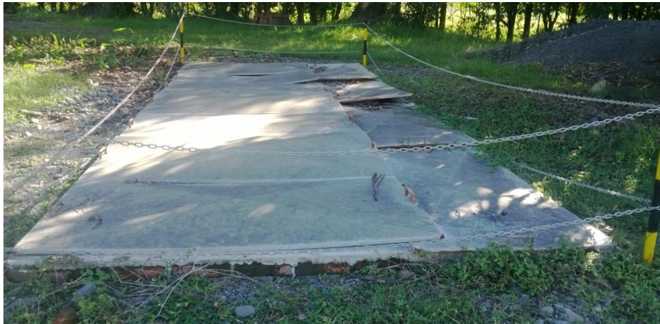
Foto No 1. Sistema de tratamiento de aguas residuales Bentocol.
