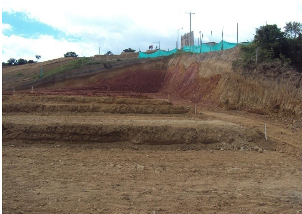
Foto No1. Adecuación del lote para la ubicación de las viviendas de interés social
