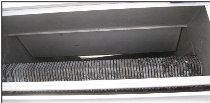
Fotos No. 1 y 2 Rejas gruesas- desarenadores tipo Vortex
