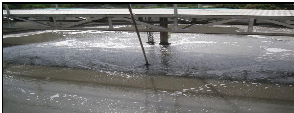
Fotos No. 3 y 4 Rejilla tipo tamiz y desarenador aireado tipo Vortex
