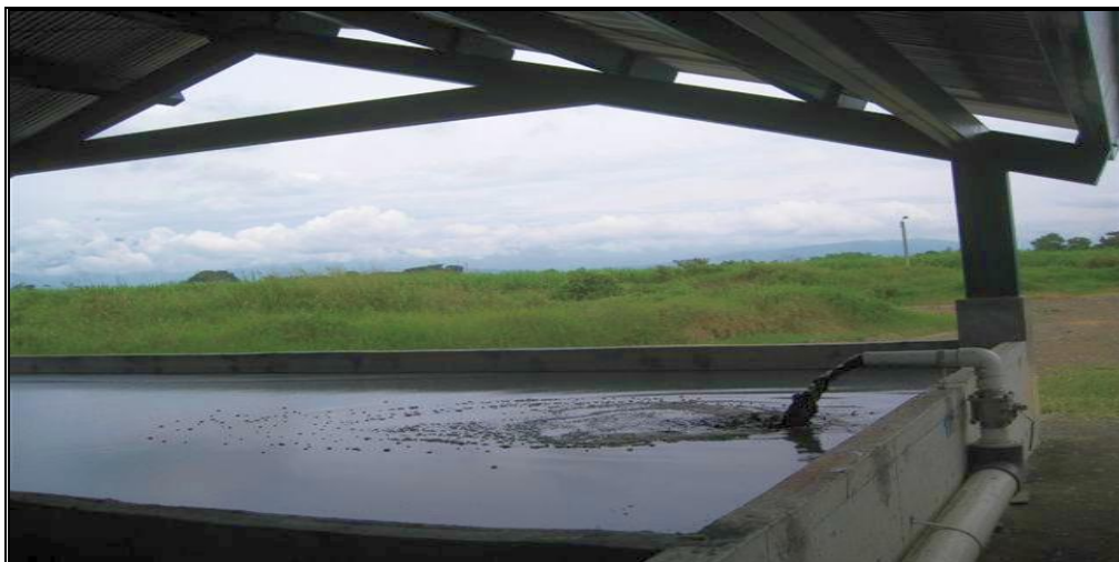
Fotos No. 11, 12 y 13 Efluente final y lechos de secado
