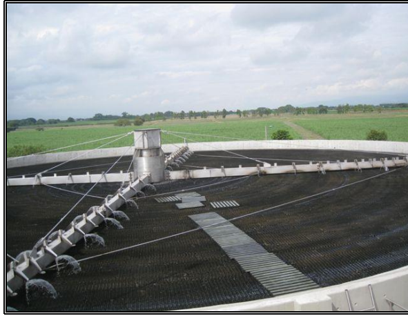
Fotos No. 5 y 6 Filtros percoladores
