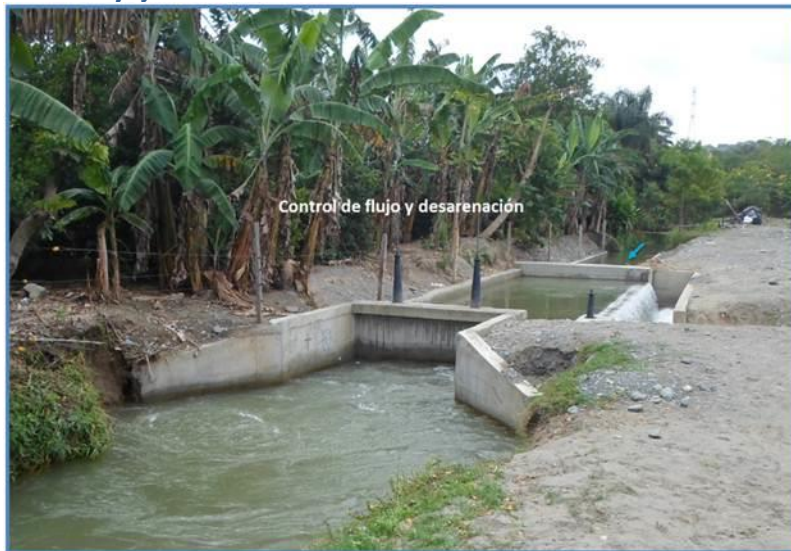
Foto 3. Obra de control de flujo y desarenador
