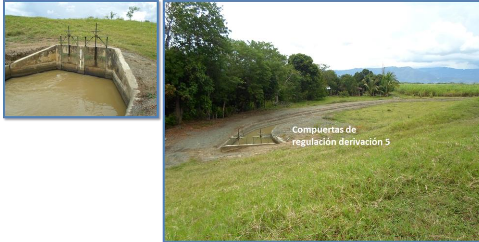
Foto 11. Compuertas de regulación de la derivación 5
