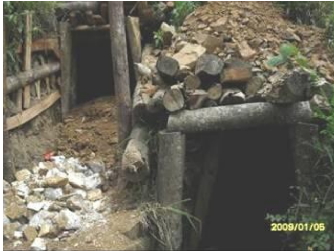
Foto 42: Bocaminas 1, 2 la Emilia, construidas bajo condiciones anti técnicas, Título La Victoria.
