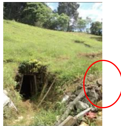
Foto 56: Evidencia de subsidencia.
