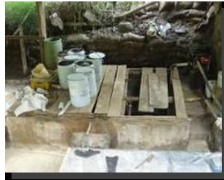
Foto 6 Tanques de recirculación
