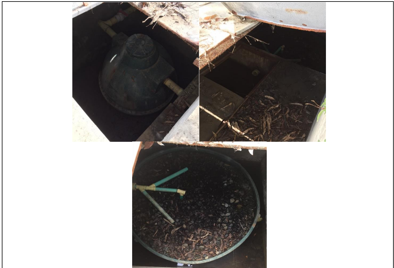
Fotografías 1, 2 y 3. Sistema de tratamiento de aguas residuales
