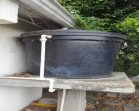
Foto No 3 tanque elevado recolección de aguas lluvias
