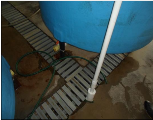
Foto N° 2. Rejillas alrededor de sala de larvicultura para evacuación y conducción de aguas de lavado de tanques.
