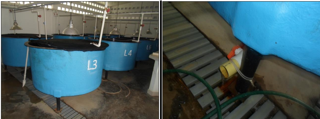
Foto N° 2. Tanques ubicados en sala de larvicultura y sistema de evacuación de aguas de lavado de tanques.
