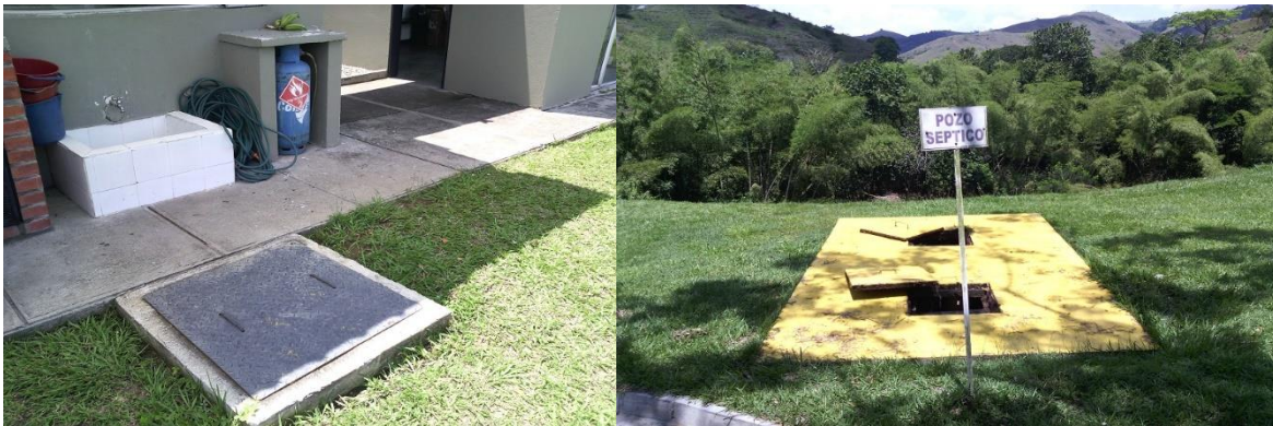
Fotos 3 y 4 En estas tomas se pueden apreciar las estructuras que conforman el sistema de tratamiento de aguas residuales domésticas instalado el peaje Corozal. En la foto 3 se observa la trampa de grasas donde llega el efluente de la cocineta, en la foto 4 se observa el tanque séptico y el filtro anaerobio.
