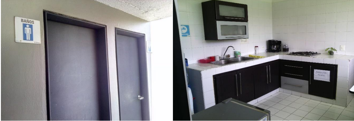
Fotos 1 y 2. En esta toma se observa las baterías sanitarias y la cocineta que hace parte del equipamiento de las instalaciones del peaje.
