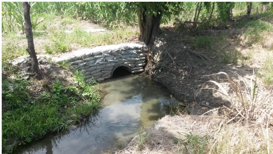
Foto 1: Detalle del sitio propuesto para la construcción de la obra de captación para el predio EL Porvenir La Suerte.
