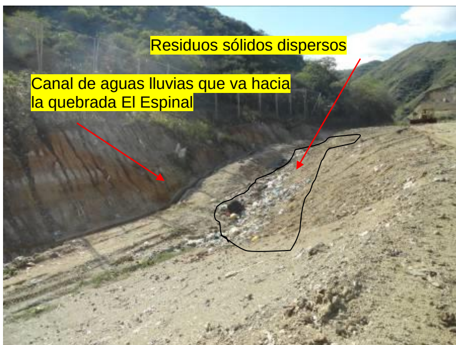
Foto No. 4 zona noroccidental vaso C2T2 con residuos sólidos sobre el canal de aguas lluvias.
