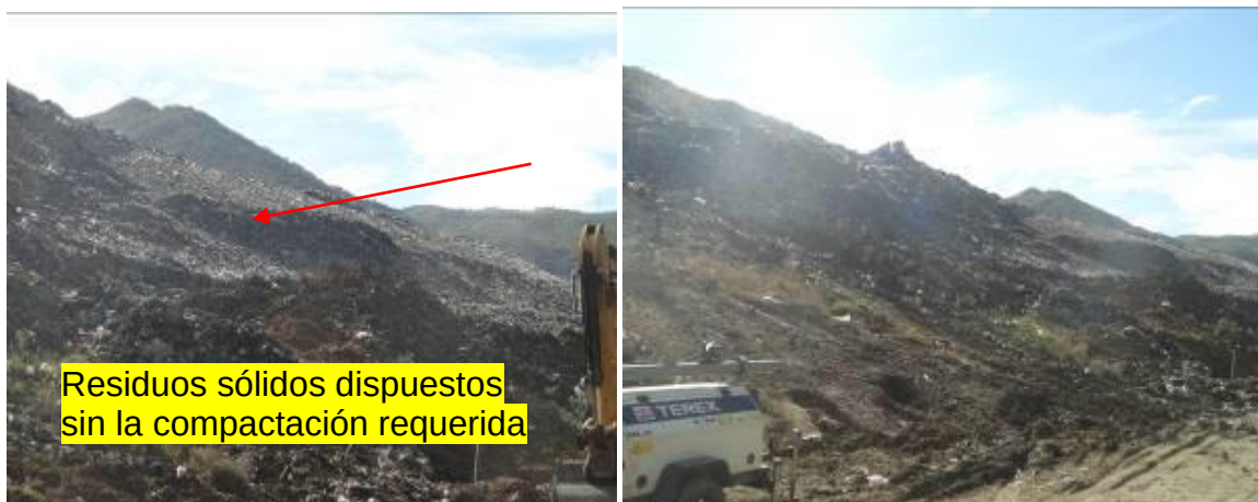
Foto No. 2 Taludes con fuertes ángulos de inclinación y sin compactación
