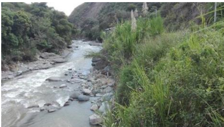
Fotos 1, 2 t 3: En las fotos se muestra fallamiento del talud inferior de la vía generando riesgo para transeúntes tanto peatonales como de vehículos.
