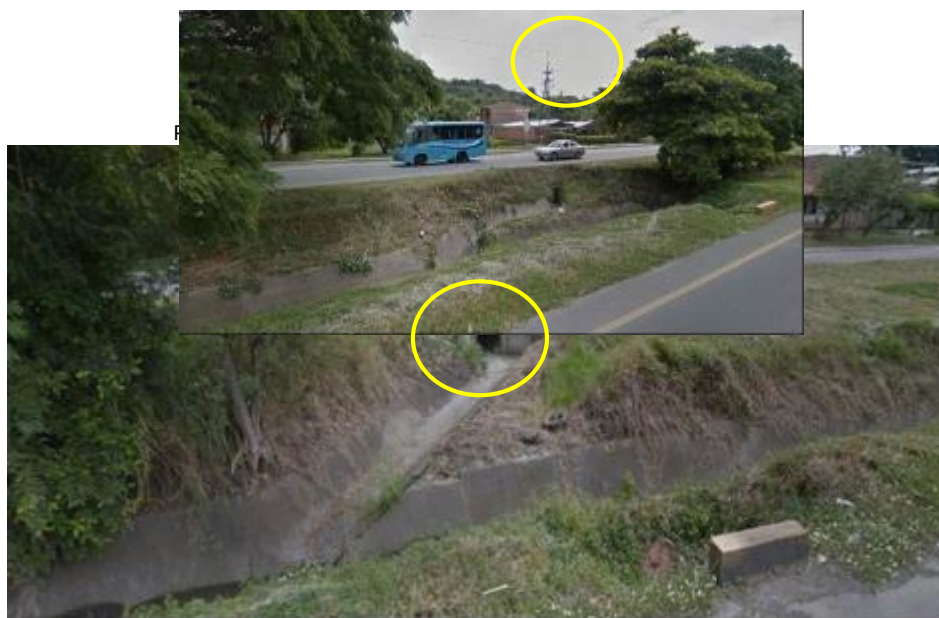
Punto de entrega de la descarga de la red de alcantarillado No 2
