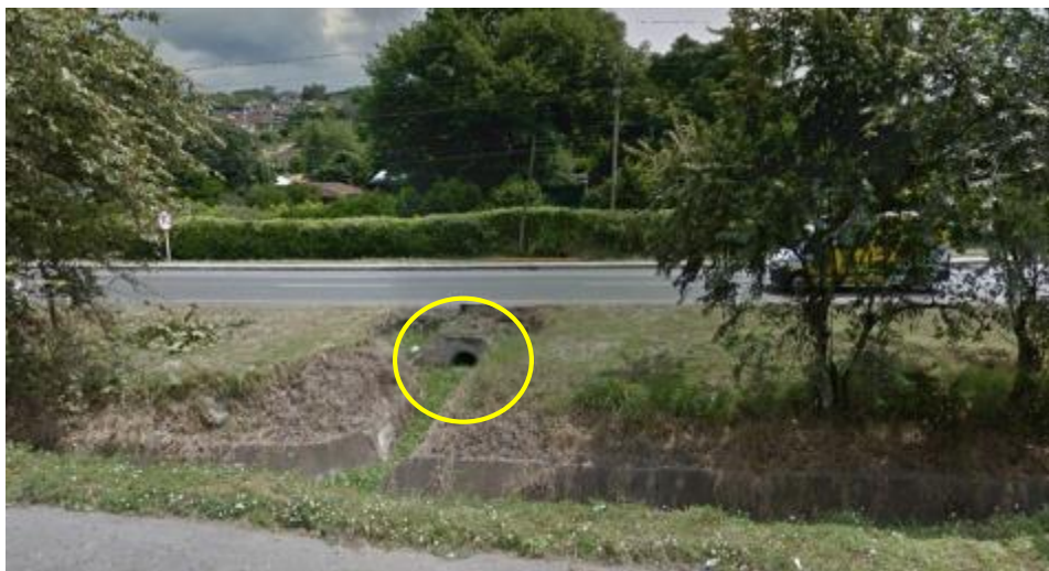
Punto de entrega de la descarga de la red de alcantarillado No 3
