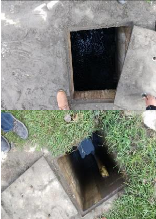
Foto 2. Ingreso al sistema de tratamiento (FAFA y Pozo Séptico)
