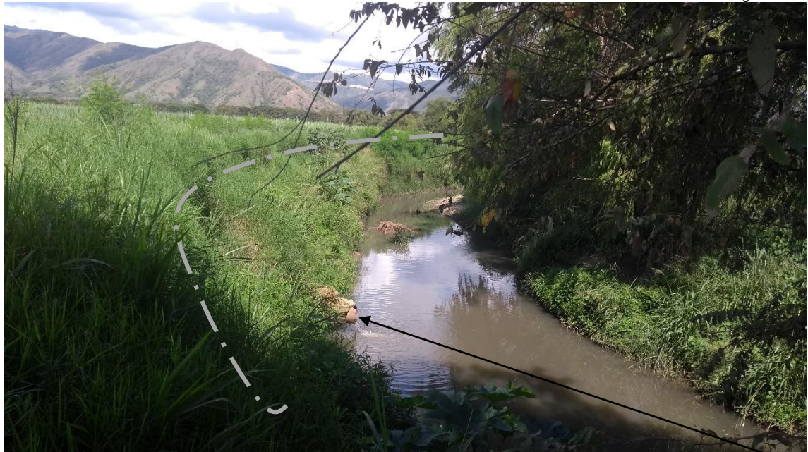
Curva donde está ubicado el Dique el cual ya perdió gran parte de su base. Y se observa la entrega del canal colector de aguas lluvias y de nivel freático.
