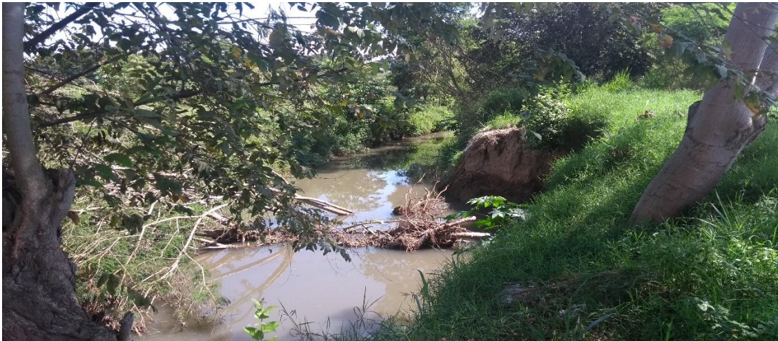
Daños estructurales del dique, por caída de árboles ubicados en la estructura del dique.
