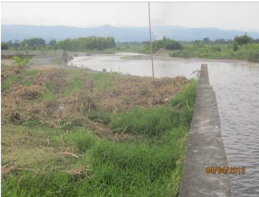
FIGURA 3.4. Muro de concreto construido en inmediaciones de la PTAR Tuluá. Izquierda (arriba): vista hacia aguas arriba; se observa el ataque directo de los flujos sobre la margen izquierda del río, y la protección que ejerce el muro construido, el cual se observa estable, aunque con eventual socavación en su pata. Derecha (abajo): vista hacia aguas abajo; el extremo final del muro genera un direccionamiento de los flujos hacia la margen derecha del cauce. Hidroconsulta, 2013.
