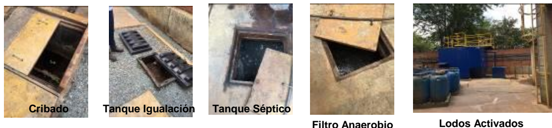
Imagen 3. Planta de tratamiento de aguas residuales (PTAR)
