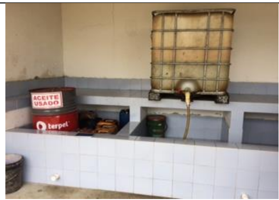
Foto 7. Punto de almacenamiento de combustibles.
