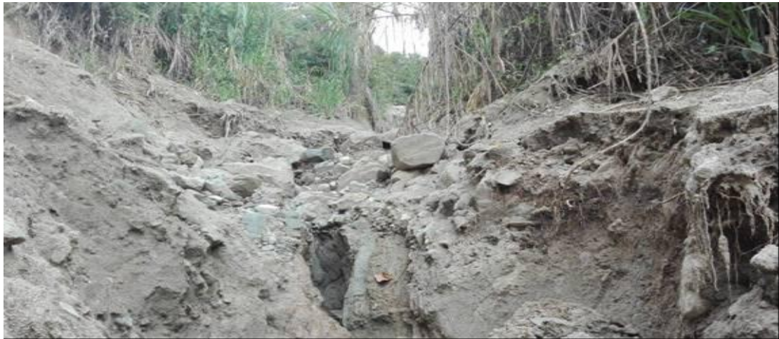
Foto 1: Detalle de la conformación rocosa, donde se evidencia la sedimentación propia de un drenaje como de depósitos de pendiente no consolidados.
