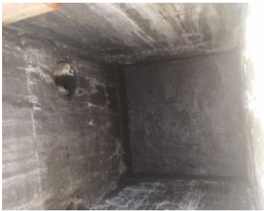
Imagen 1. Tanque Unificador de Caudales
