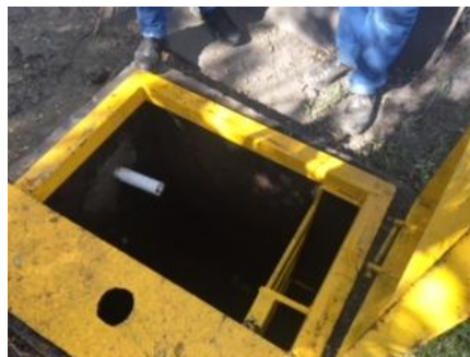
Imagen 5. Segunda estación de bombeo donde llega el vertimiento del Trapiche del Valle y D`Kaña para ser conducido al primer tanque sedimentador
