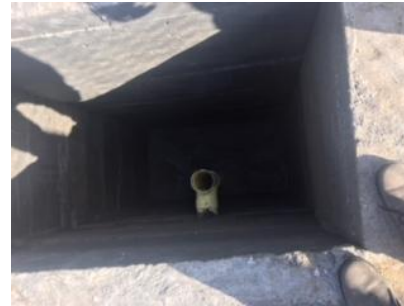
Imagen 3. Estación de Bombeo
