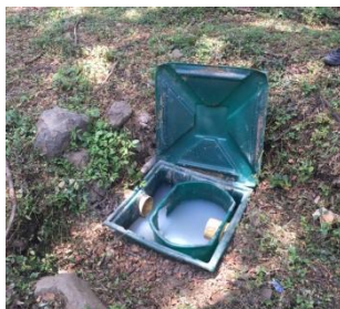
Foto 1. Caja ubicada antes del tanque séptico que recolecta las aguas residuales de todo el hospedaje
