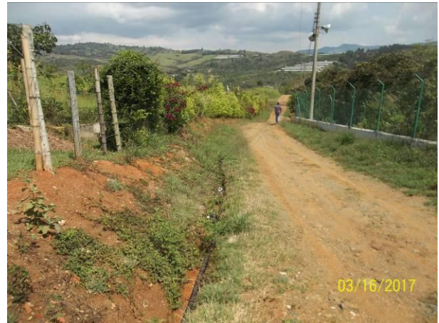
Foto 6. Cunetas para el manejo de agua lluvias.
