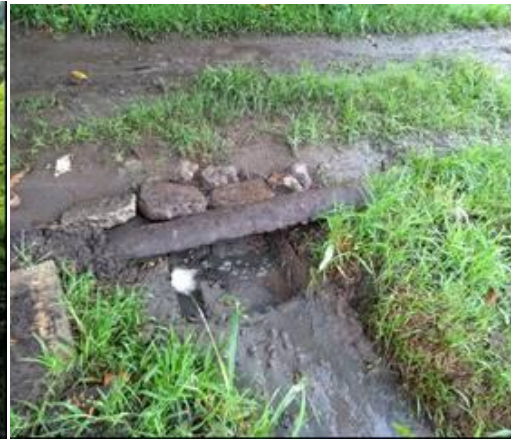
Foto 7 y 8. Cámara sedimentadora
