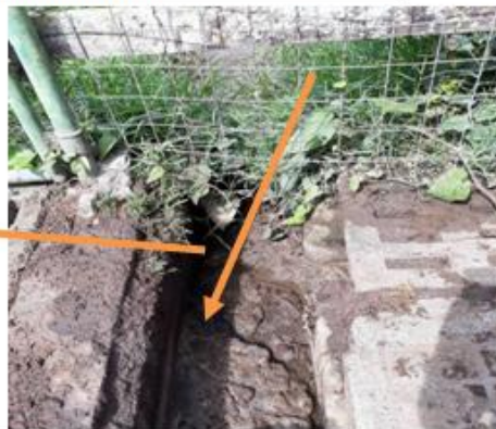
Canal recolector principal de aguas residuales, que descarga en tanque estercero capacidad de descargar a la quebrada la María o a los potreros directamente sin
