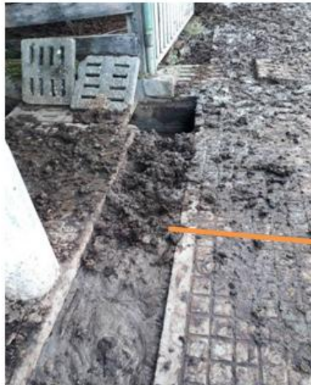
Canal perimetral colmatado
