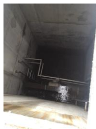
Cámara de entrada
