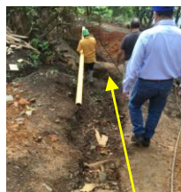
Sitio de ubicación de trampa de grasas y almacenamiento de aguas grises
