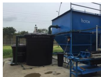
Dosificación de cloro y salida del vertimiento
