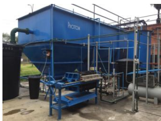
Reactor de aguas residuales no domésticas (ARnD)
