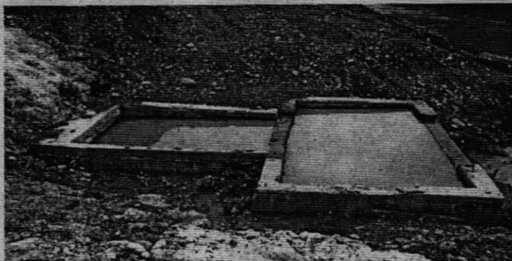
Fotografía. No. 5. Sedimentadores existentes para la retención de sólidos.
