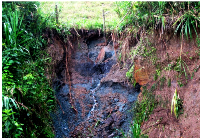
Foto 4. Deslizamiento sobre suelo residual
